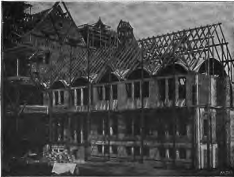
FIG. 247.—Fireproof Monier arches over the gynasium of the school in the Gatzingerplatz, München.
